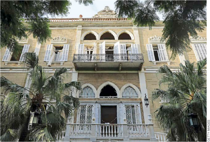
Sopra, le finestre danneggiate del Sursock Palace dopo la tragedia al porto di Beirut, da cui dista tre chilometri. Il restauro è affidato, tra gli altri, all’ente Baladi e allo Smithsonian
